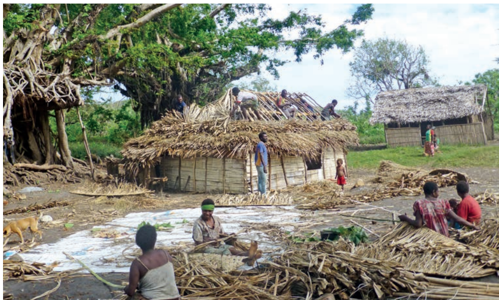
Viharkárok helyreállítása a Pam ciklon pusztítása után
